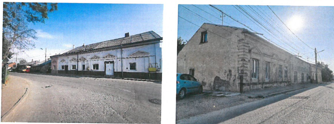
FIGURA 47 – Zone cu o calitate slabă a locuințelor – Cartier Ițcani
