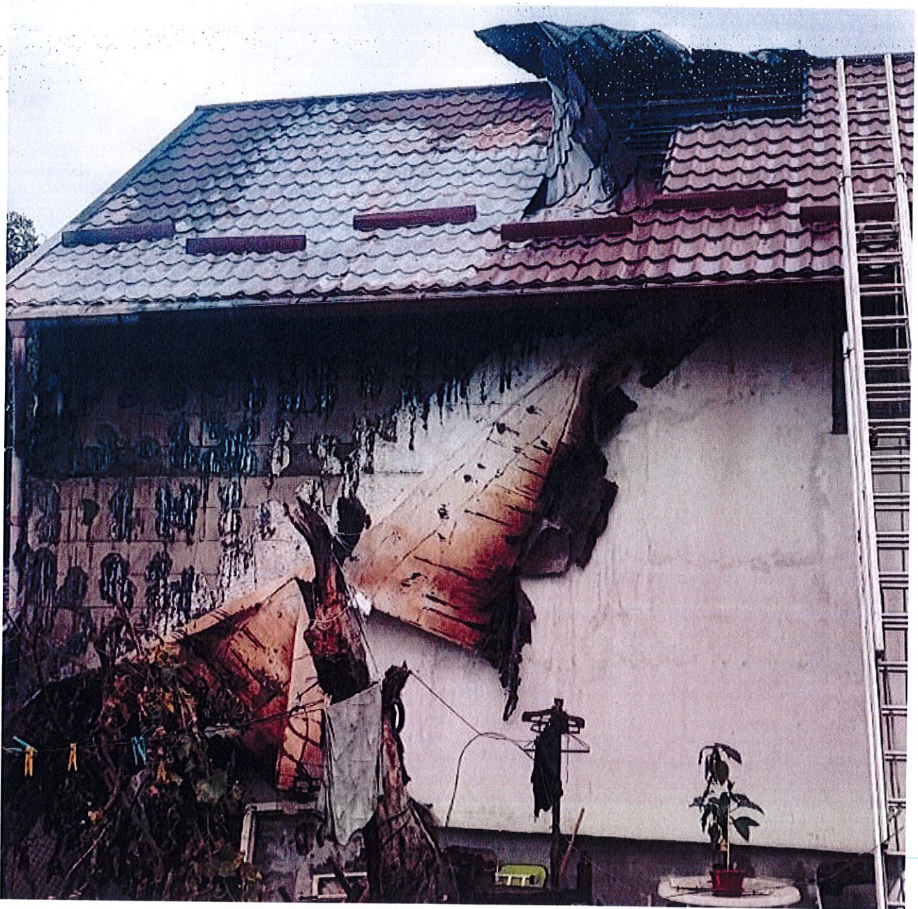
Distrugerii cauzate de incendiu la nivelul fațadei și acoperișului la imobilul de pe strada Cernăuți, nr. 100 (învecinat cu imobilul de la care s-a produs incendiul și ulterior s-a propagat la acesta)
