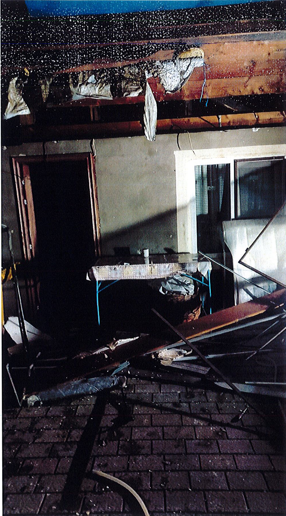
Afectare anexei gospodărești de la imobilul nr. 100
