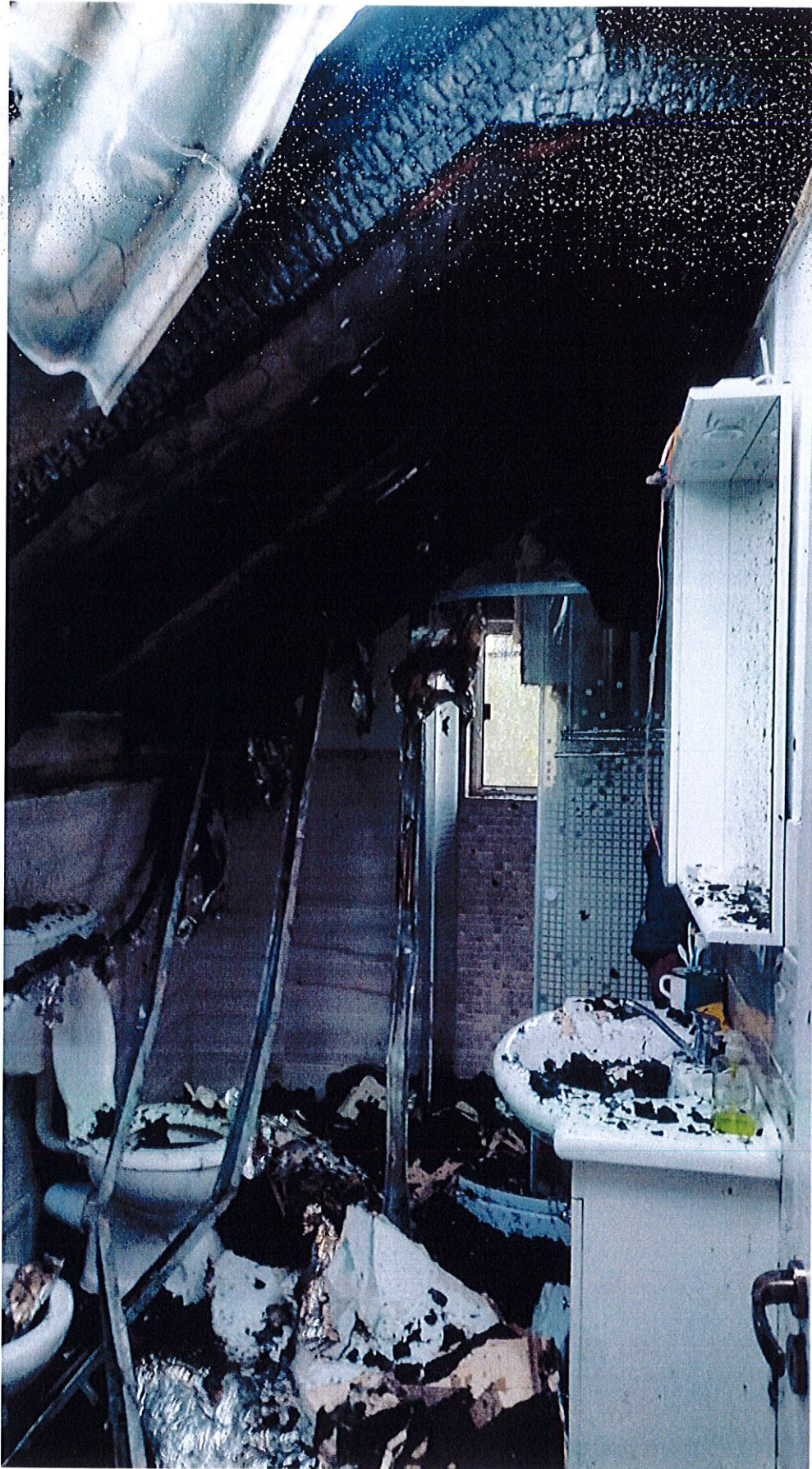
Distrugerea acoperișului și a spațiilor de locuit din mansarda imobilului de la nr. 100 (adiacent sursei de la care a fost provocat incendiul – imobilul de la nr. 102)
