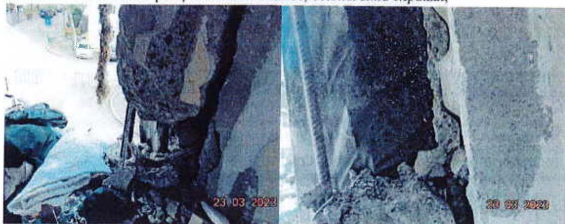
Figura 41 Degradare monolitizări panouri prefabricate pereți
