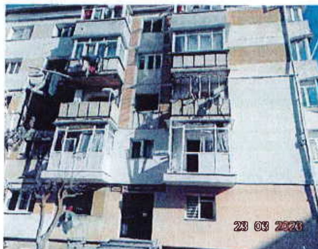
Figura 6 Aspect fațadă principală după explozie
