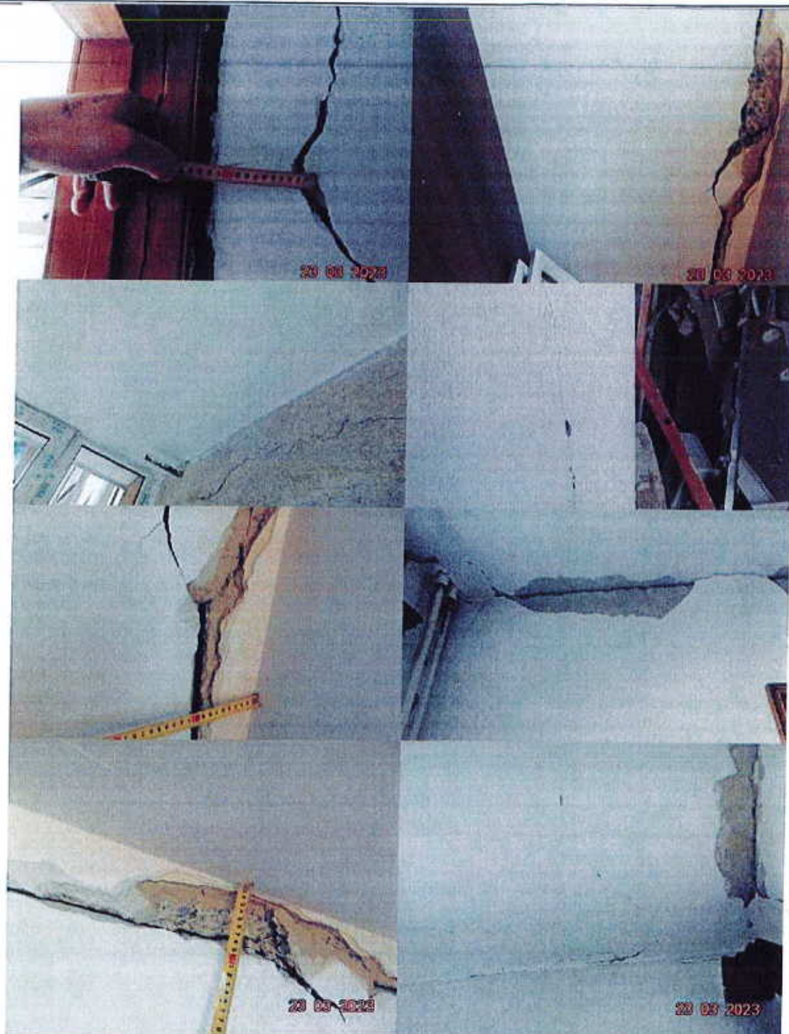
Figura 45 Crăpături apărute la nivelul pereților
