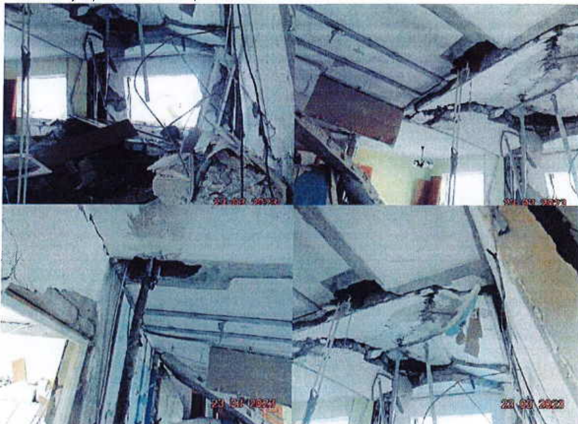
Figura 52 Modul de cedare al planșeului în zona axelor 11-13/B-C la cota +8,35m
