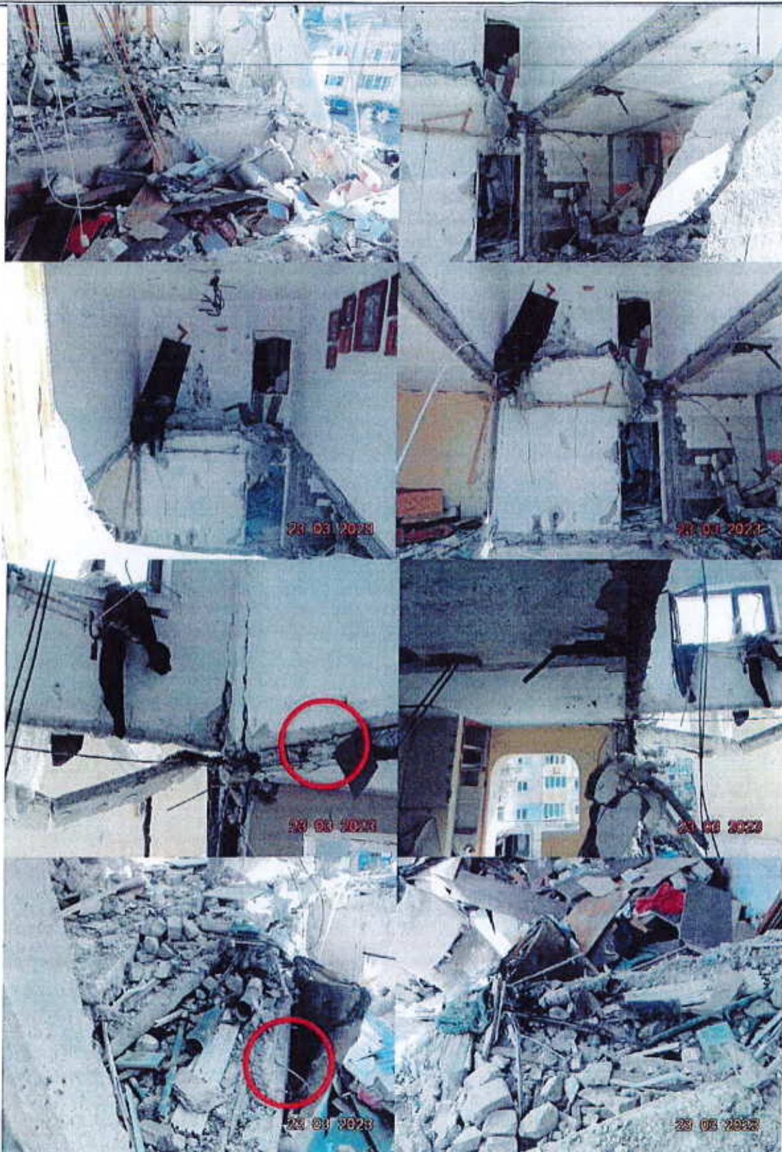
Figura 51 Plăci prăbușite la etajele 2 și 3 (cu roșu barele de armare pentru continuitate)
