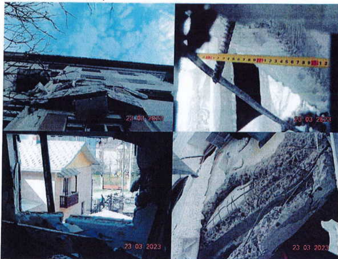
Figura 33 Degradări ale peretelui din axul C/11-12
