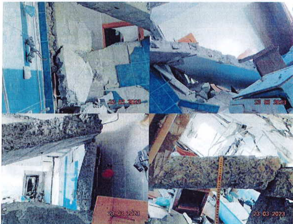
Figura 38 Degradări ale pereților din axele 11 și 12 / B-C
