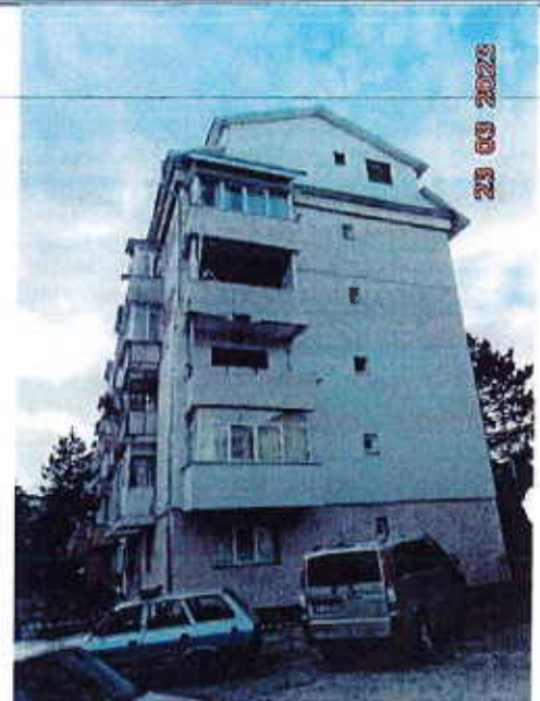
Figura 7 Aspect fațadă laterală după explozie
