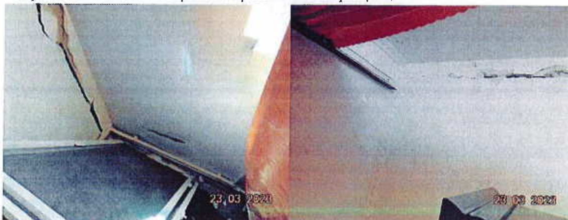
Figura 44 Desprinderi ale panourilor de monolitizări
