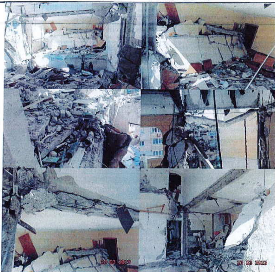
Figura 35 Degradări ale pereților din axele 11 și 12 / A-B
