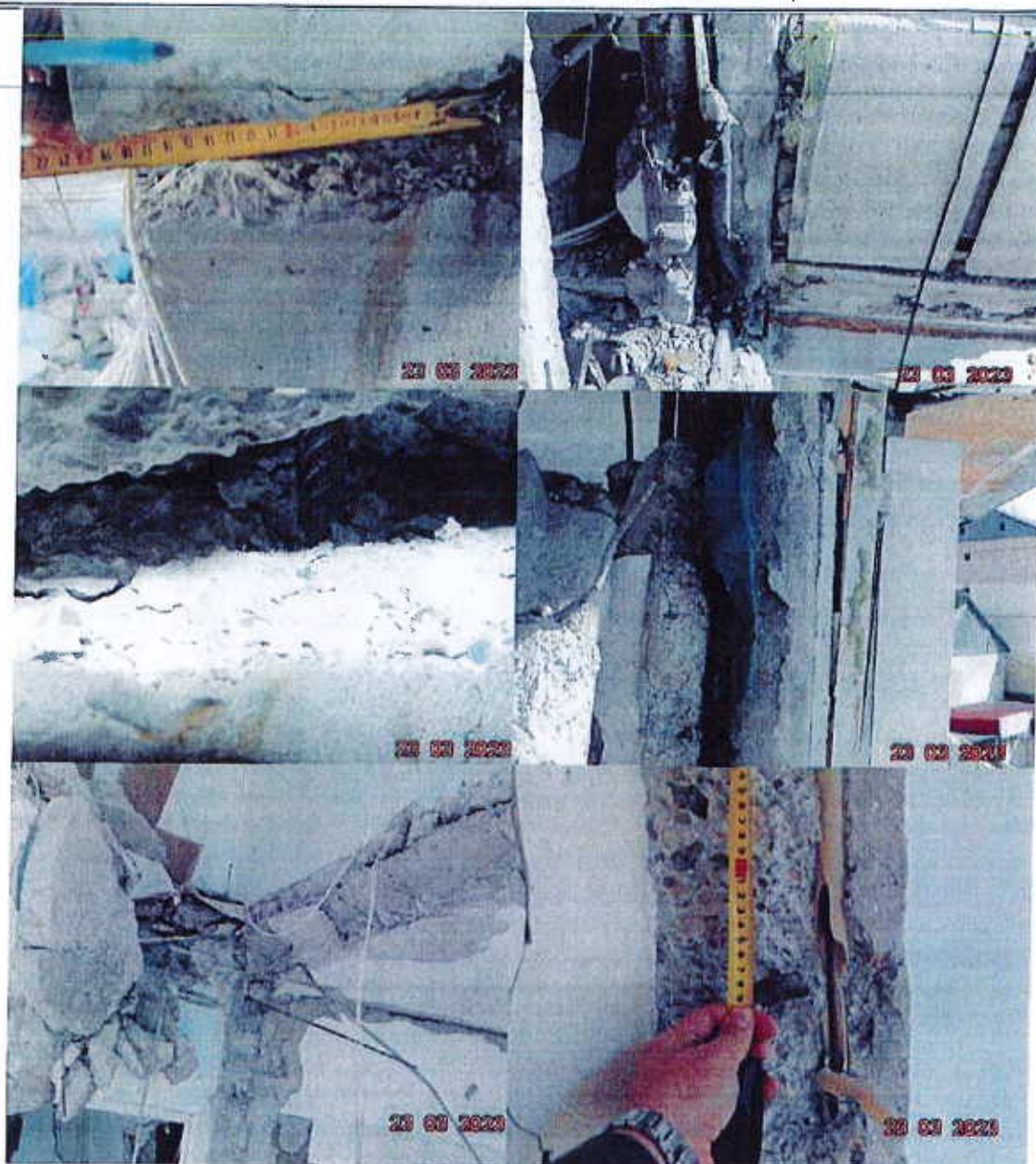
Figura 42 Degradare monolitizări panouri prefabricate pereți
