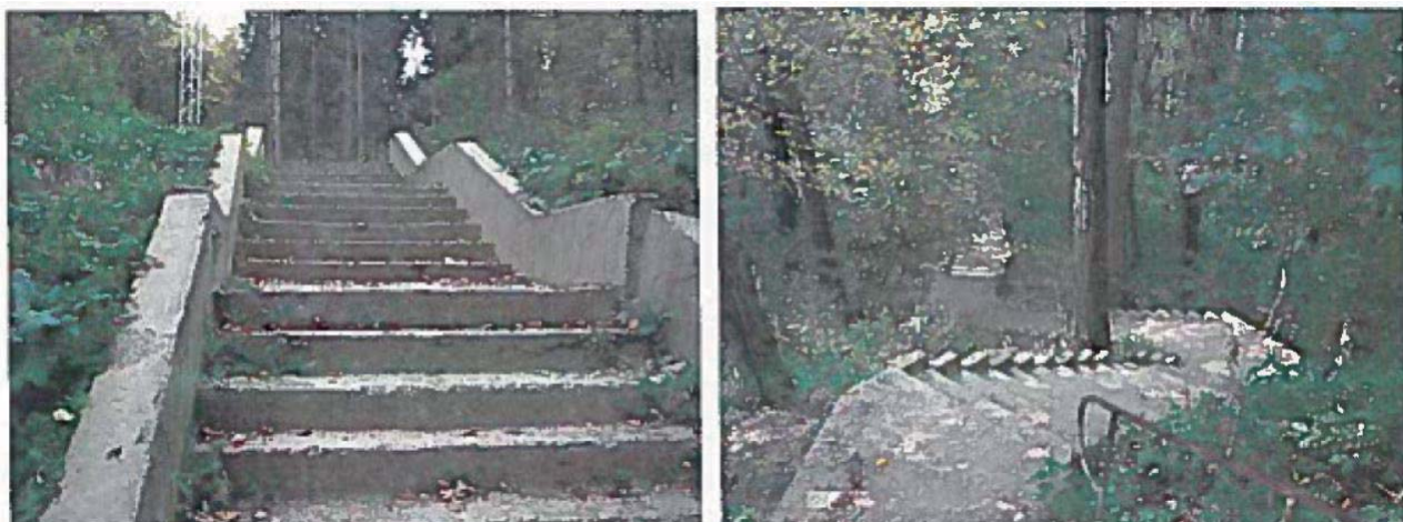
Fig. Aleea cu trepte – zone cu deteriorari ale suprafetelor si zidurilor de sprijin
