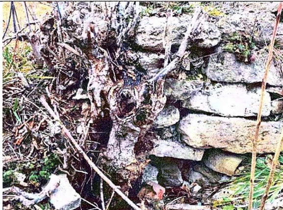
Rădăcini ale plantelor superioare (arbori, arbuști) dezvoltate printre elementele litice ale zidurilor provocând desprinderi, dislocări, prăbușiri
