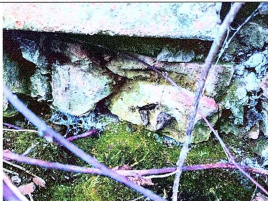
Locul de prelevare a probei nr. 7 – Zid refăcut (1970-1980) – Ruinele Epoca Ștefan cel Mare (ante 1485), partea de est - la stradă, ziduri vechi, zona inferioară, umiditate ridicată
