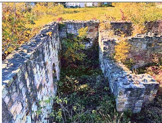
Ziduri reconstituite în urma ultimelor lucrări de restaurare invadate de vegetație – degradări active produse de activitatea distructivă a biodeteriogenilor
