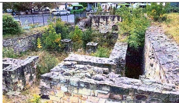
Ziduri reconstituite în urma ultimelor lucrări de restaurare invadate de vegetație – degradări active produse de activitatea distructivă a biodeteriogenilor
