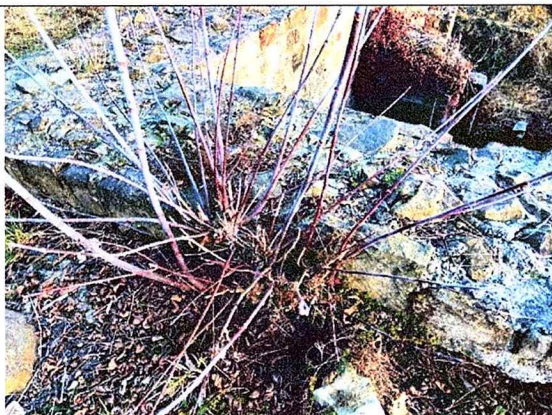
Locul de prelevare a probei nr. 9 – Zid refăcut (2000-2005) - Zona pivnițelor din partea de est – considerate ca aparținând lui Vasile Lupu se observă arbuști dezvoltăți la baza zidului
