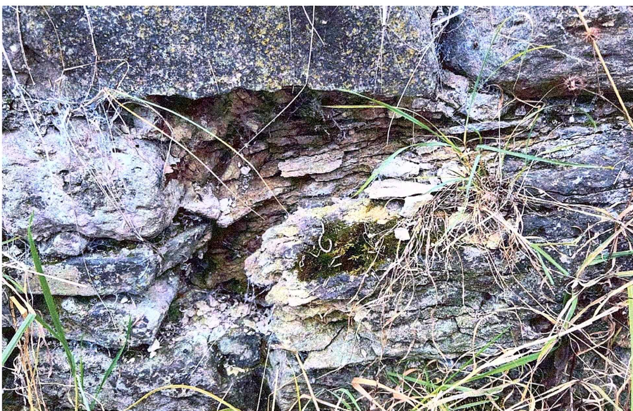
Forme de degradare - dezintegrare prin pierderea coeziunii - elementelor litice și a mortarelor
