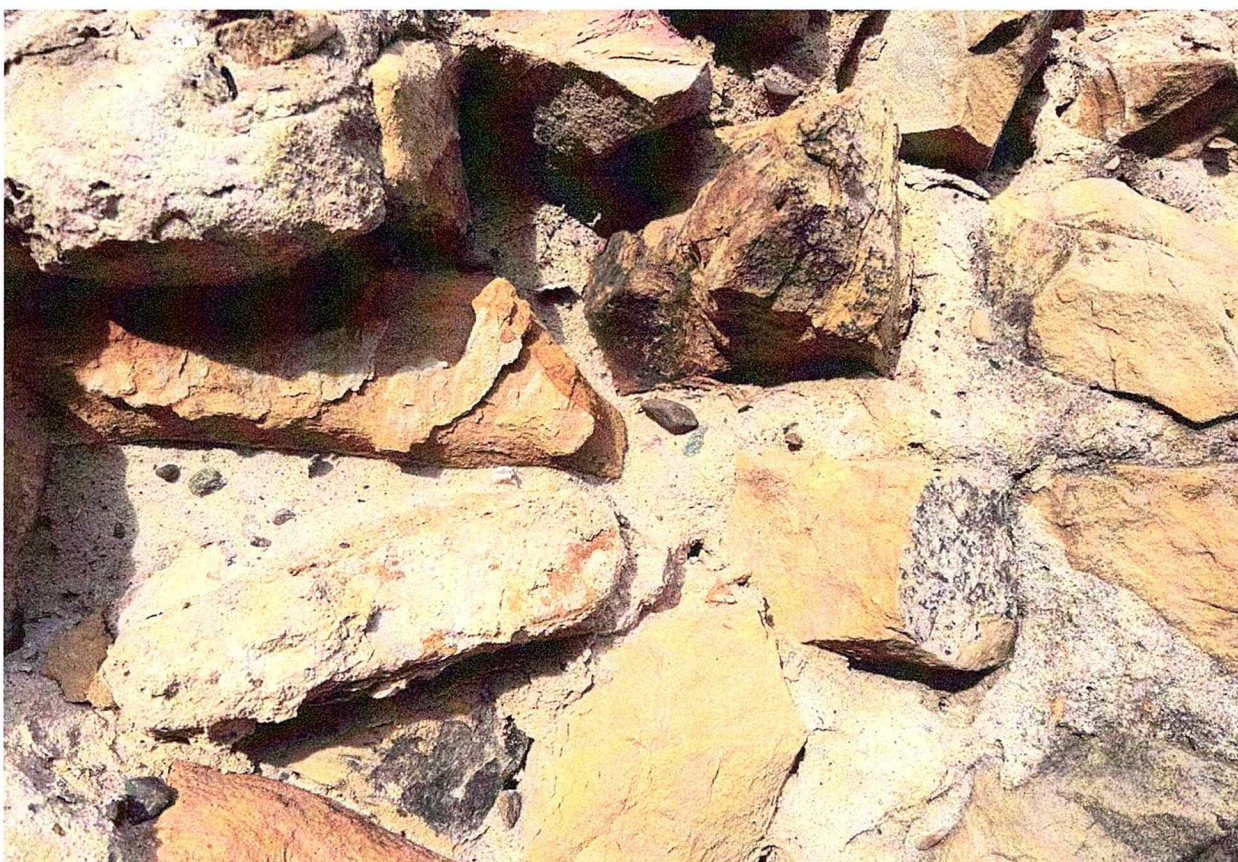
Forme de degradare - dezintegrare prin pierderea coeziunii - elementelor litice și a mortarelor
