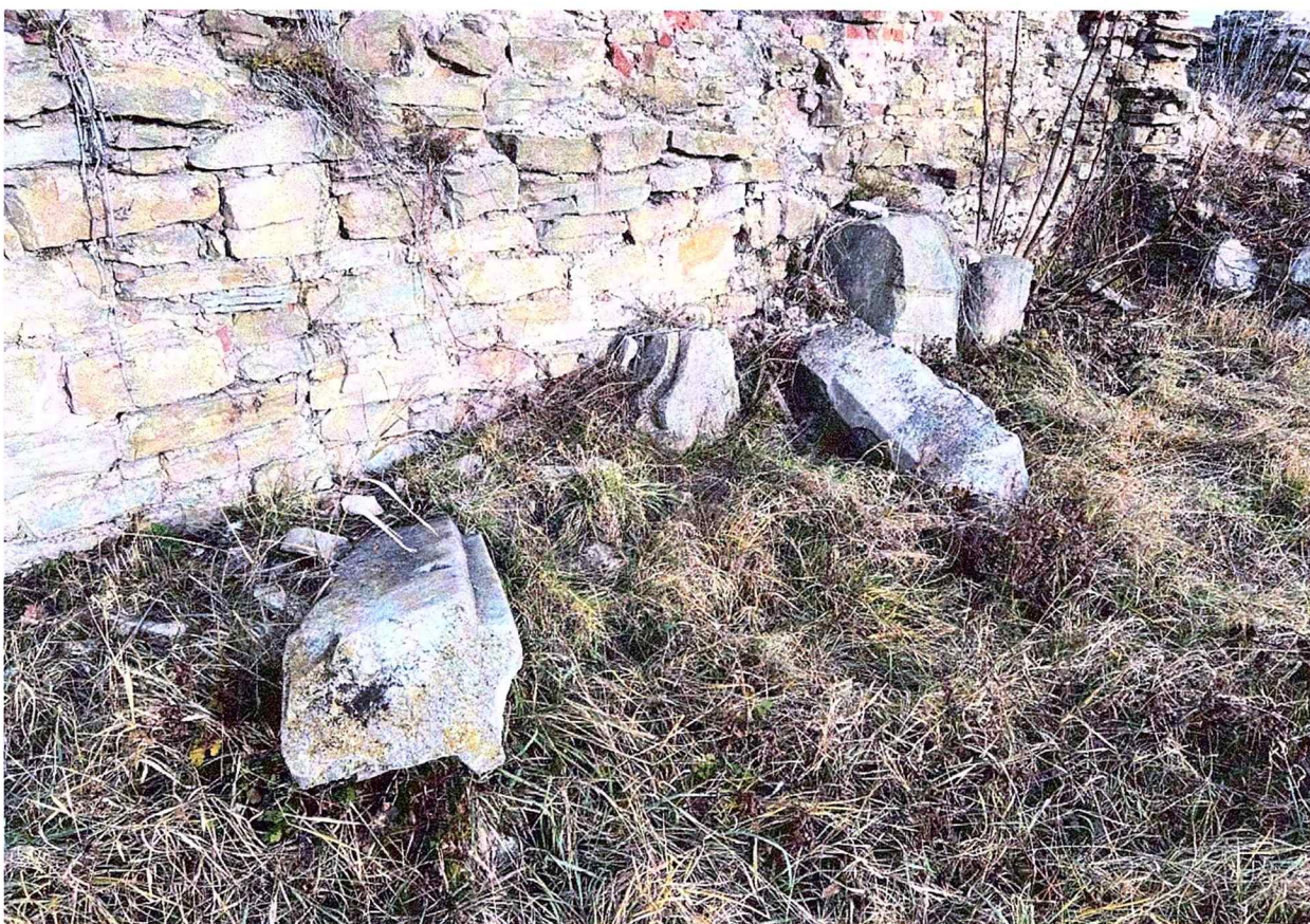
Modul neglijent de depozitare a unor elemente sculptate componente artistice ( părți ale unor portaluri, sau ancadrame de ferestre), acoperite de arbuști, alge, licheni și briofite
