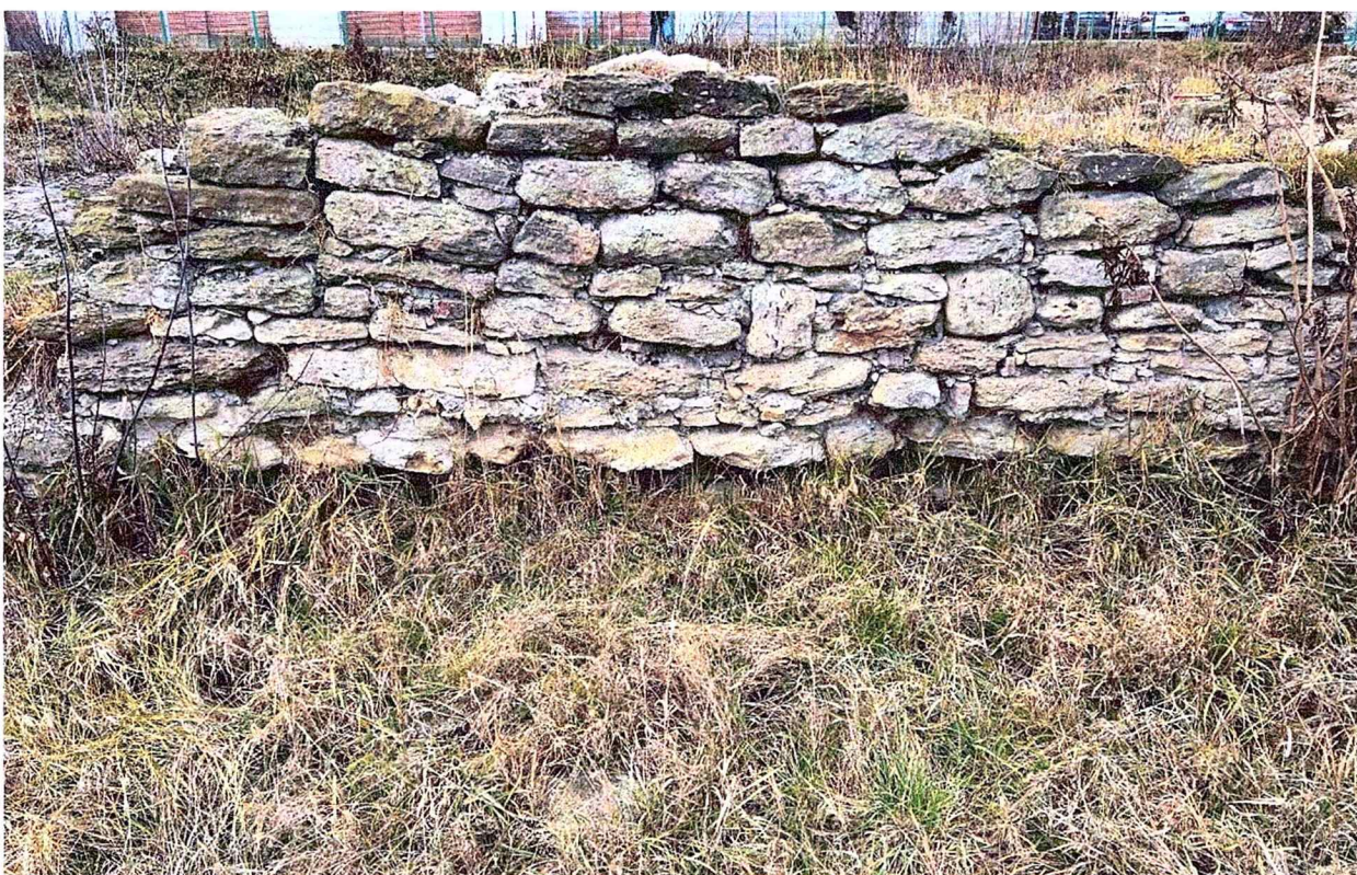
Degradări a elementelor din piatră, caramidă și pierderea mortarelor de rost, cauzate de expunerea la intemperii și a fenomenului îngheț-dezgheț
