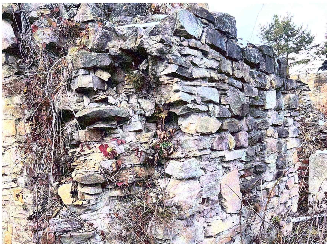
S-au identificat dislocări ale zidăriei, degradare rezultată în urma pierderii mortarelor de rostuire
