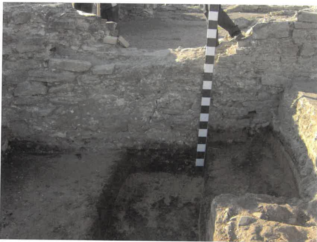
Fig. 16. Diferențe de fundare la construcția C 5 (campania 2006) au provocat fracturi în zidărie
